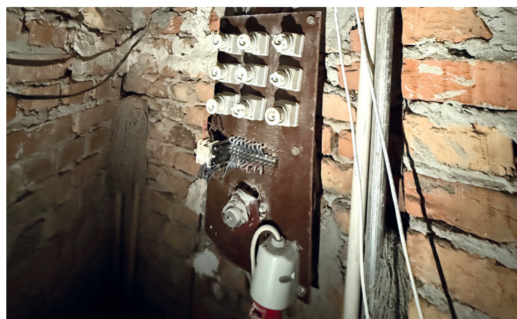
Stara rozdzielnia elektryczna
