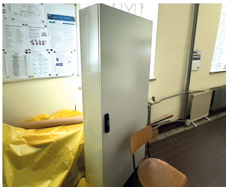
Nowa szafa, w której znajdzie się centrala elektryczna
