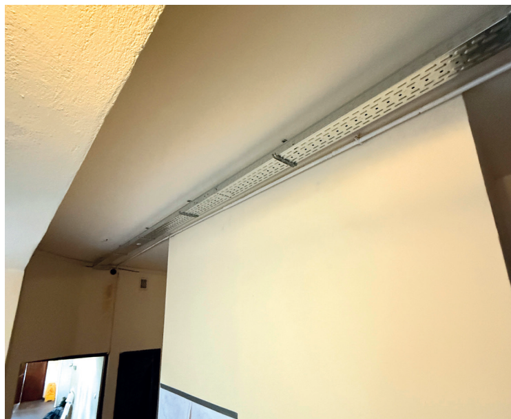
Prowadnice pod kable pod sufitem w korytarzu przy zakrystii
